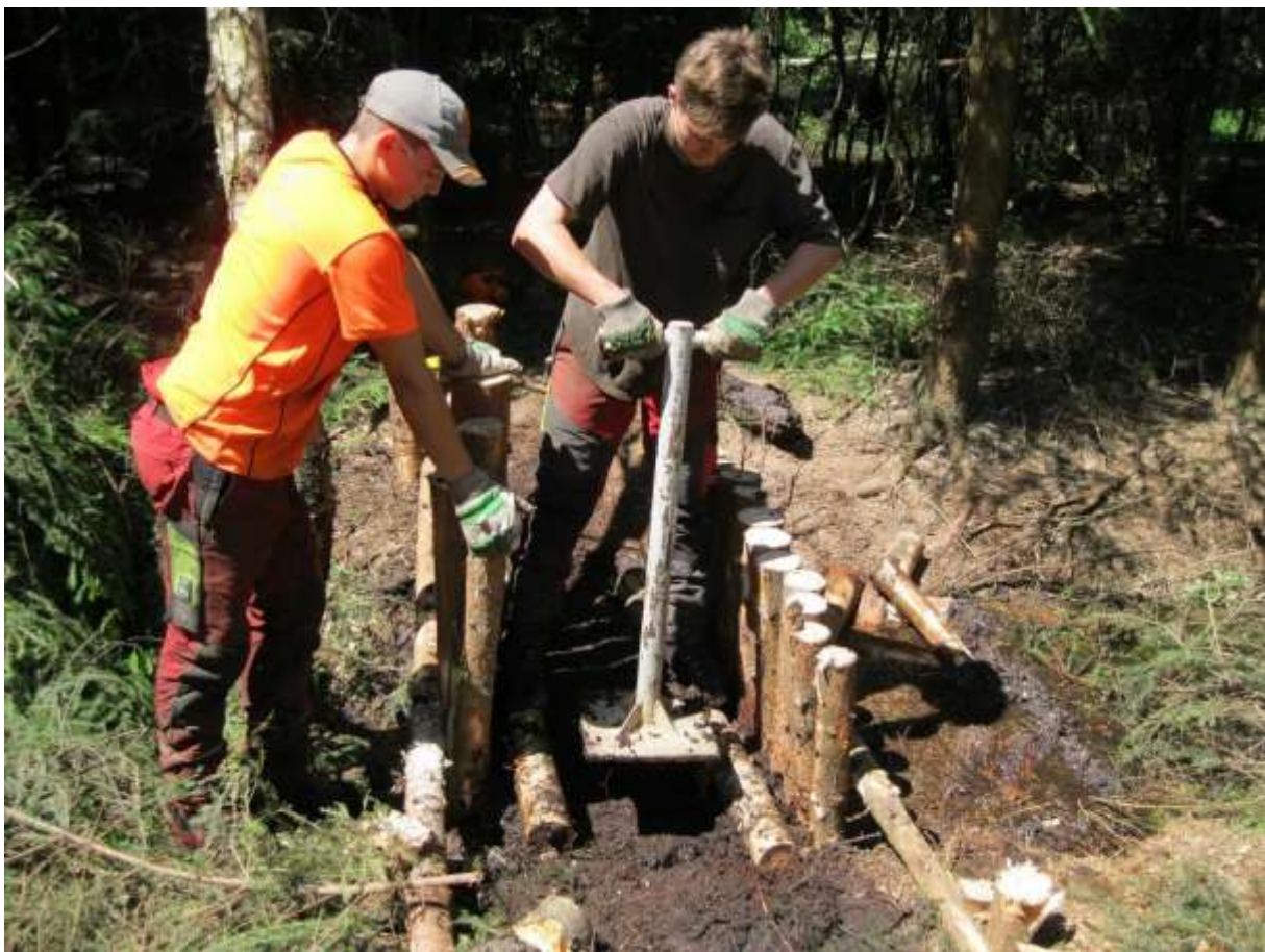
Abb. 10: Die angehende Forstwirte Johannis Zagorski und Roman Görtz (v.l.) verbauen im Diebsteigmoor einen Entwässerungsgraben in Korsettbauweise (Aufn.: T. Küchler).
